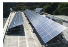
最大出力30kwのソーラーパネル
